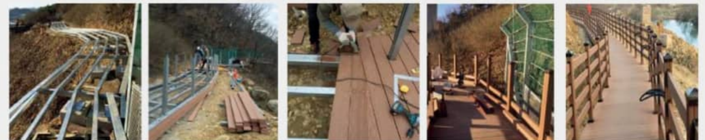
① 하지 작업 ② 데크 설치 전 난간 기둥용 속주 설치 ③ 데크설치 및 마감 ④ 난간 설치 ⑤ 완성
